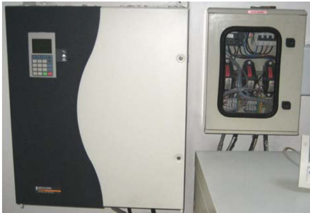
Figure 7 : Compensateur actif SineWave (MGE UPS SYSTEMS™) de calibre 20 A (à gauche). Transformateurs d'intensité pour les mesures et les apports des courants de compensation (à droite).
