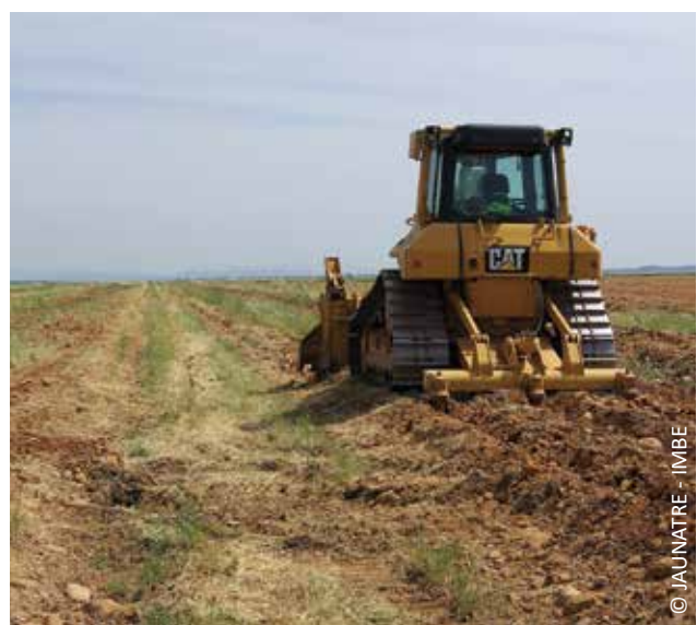
Décompactage du sol du verger intensif de Cossure après arrachage des pêchers et avant semis ou transfert de foin pour la restauration
